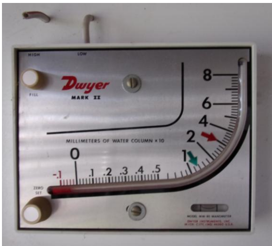
DETALLE DEL MEDIDOR DE FLUJO DE AIRE
